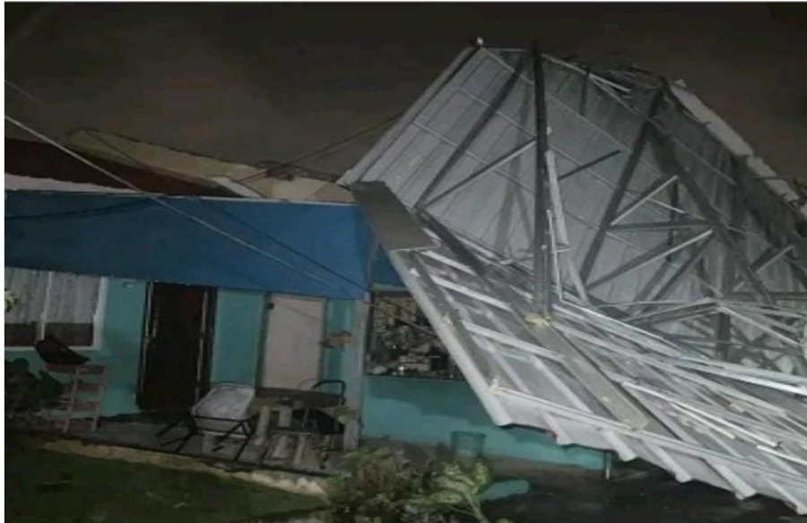
Gambar 1. 1 Contoh Kerusakan Pada Atap Perumahan Konsumen Pinang Mas Residence
