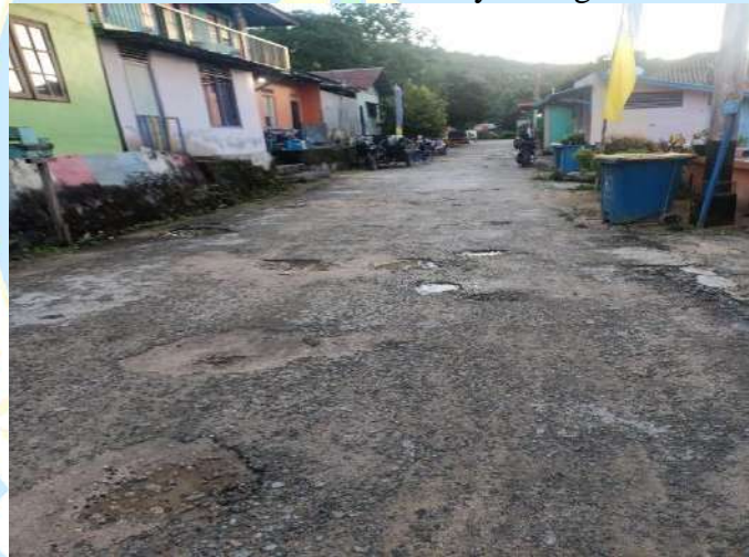
Gambar 1.1 Akses Jalan Raya Yang Rusak
