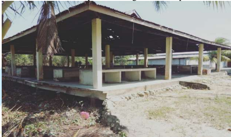
Gambar 1.1 Kondisi pasar sawang sebelum diperbaiki
